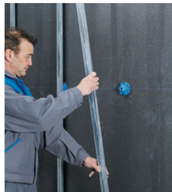
Vérifier l'étanchéité à l'air. Éventuellement, combler avec une mousse PU ou un adhésif aux joints. Puis, clipser la fourrure.
