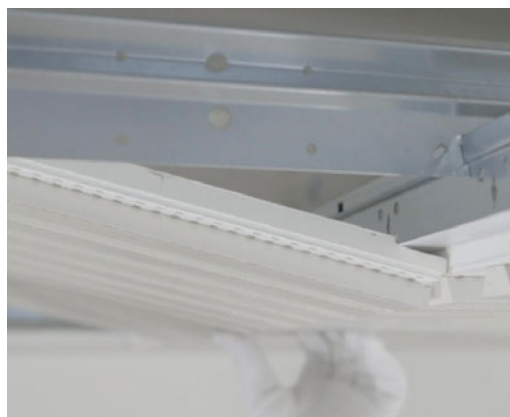
Fig. 7 : Installer les panneaux en glissant les platines métalliques des plaques derrière le T du porteur T24.
