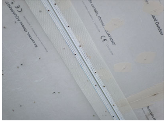
Joint de fractionnement
